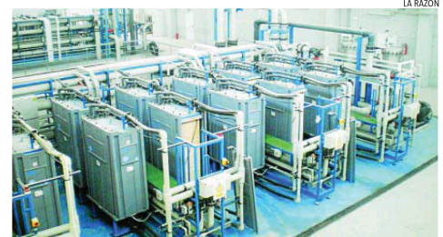
Las instalaciones de la planta desnitrificadora de L'Eliana
